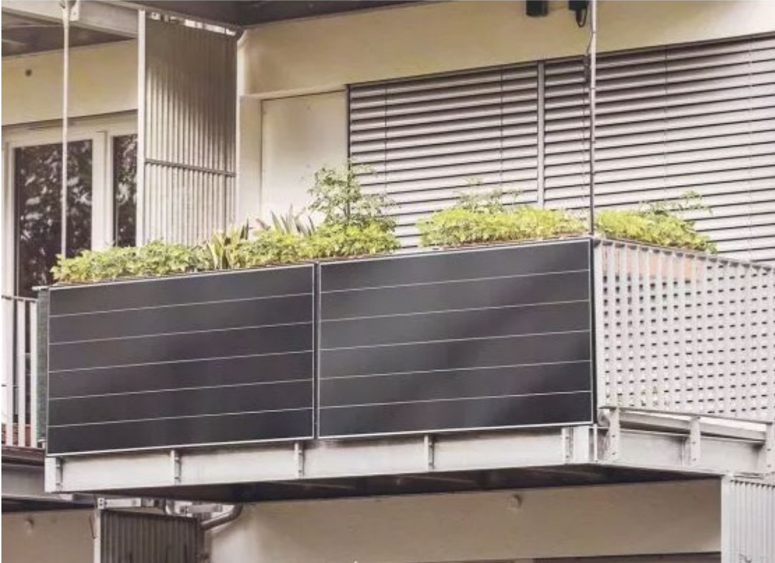
Balkonsolaranlage 720 Wp/800 VA
